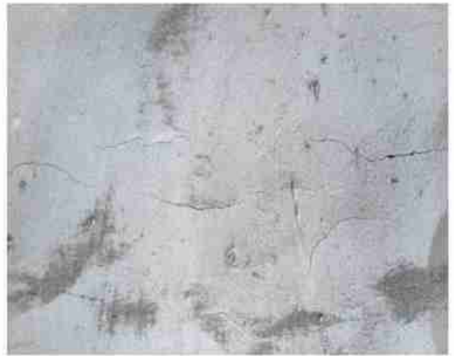
Bề mặt vữa thô phồng rộp do tổ vữa xi măng cát không tương thích trực tiếp lên tường gạch AAC
